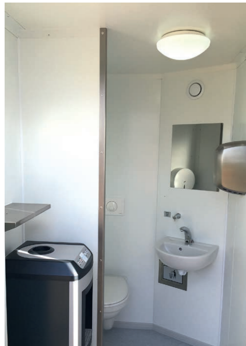
Intérieur de sanitaires et équipements suivant cahier des charges
